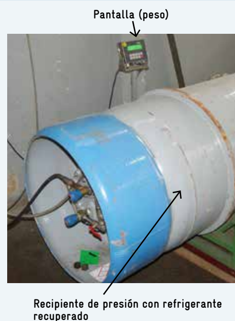
Figura 10. Tanque de presión sobre báscula. Contiene refrigerantes recuperados que han sido extraídos
